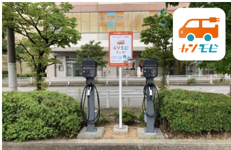
EV 充電器写真
